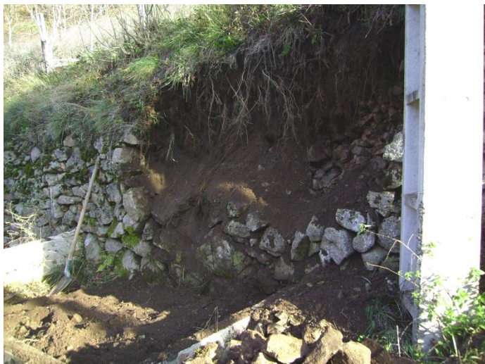
Eboulement et reconstruction d'un mur à Crouzes :
